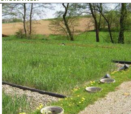
Station d'épuration en filtres à roseaux à écoulement vertical
